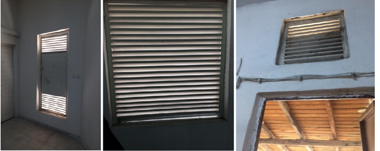
Resim 4.3. Makine dairesi havalandırmaları
