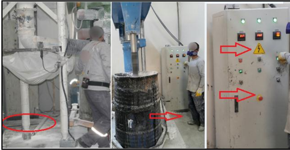
Resim 4.23. Önünde yalıtkan paspas bulunan elektrik panosu (solda), önünde yalıtkan paspas bulunmayan pano (ortada), mikser panosunda bulunan elektrik tehlikesi işareti ve acil stop düğmesi (sağda)
