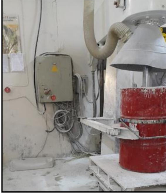
Resim 4.24. Önünde yalıtkan paspas olmayan elektrik panosu ve kabloların uygunsuz durumu
