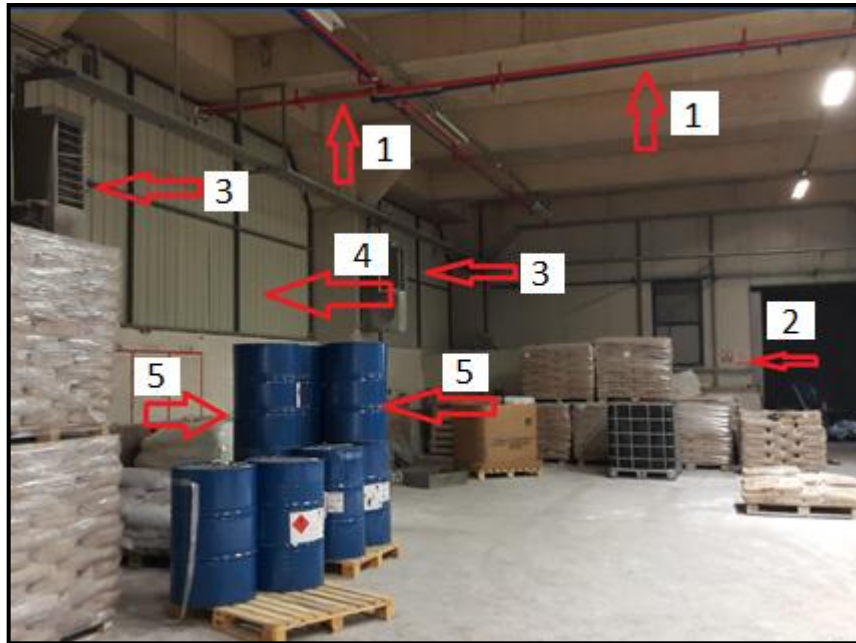
Resim 4.18. 1) Depoda köpüklü sprink sistemi, 2) uyarıcı levhalar, 3) havalandırma 4) güneş ışığını önleyici paravanlar, 5) polyester tanklarının uygun olmayan istiflenmesi
