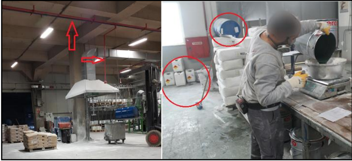
Resim 4.21. Hamurhanede köpüklü sprink yangın söndürme sistemi (solda), yangın dolabının önünde istiflenen yanıcı organik peroksit ve polyester (sağda)
