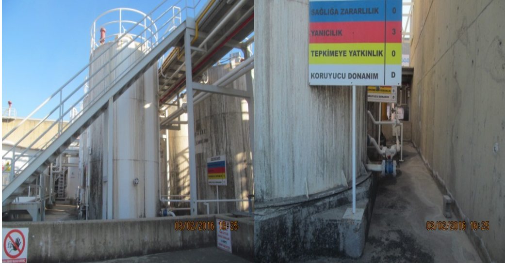
Resim 4.3. Yerüstü solvent tank sahası tesis fotoğrafı
