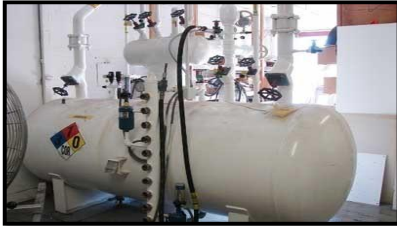
Şekil 2.9. Depolama (Receiver) tankı
