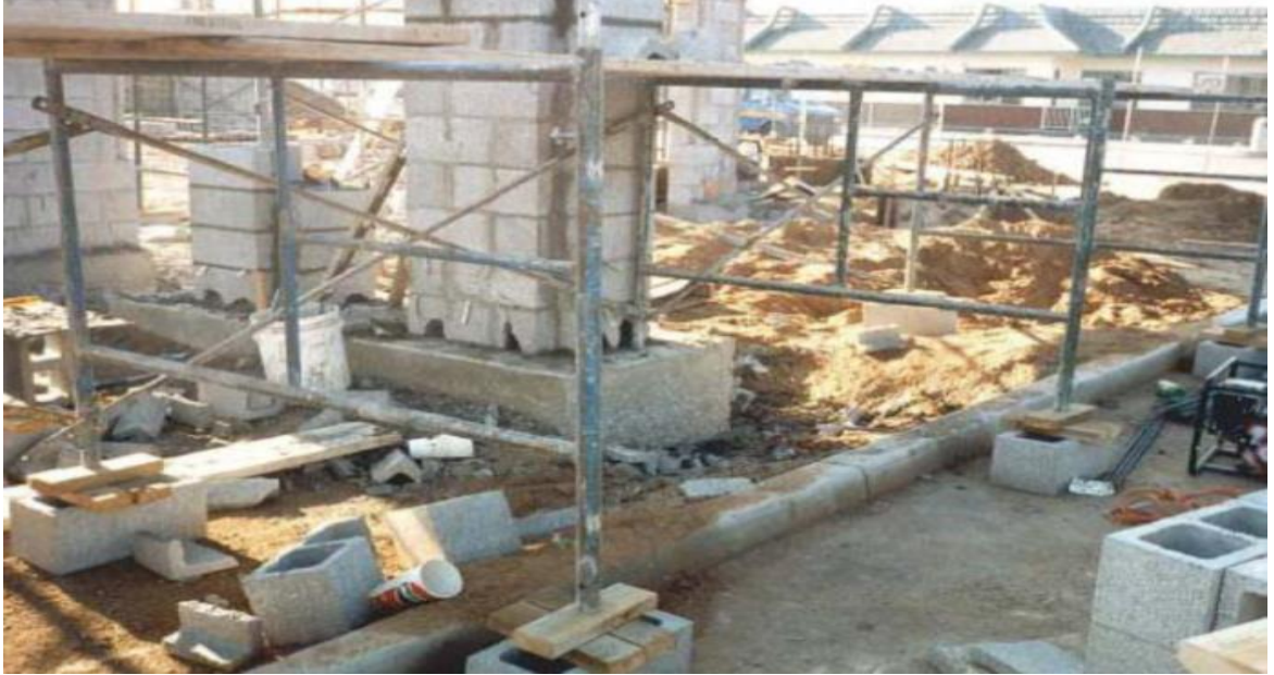
Şekil 76. Standartlara uygun olmayan iskele tabanı; çökme riski [24]
