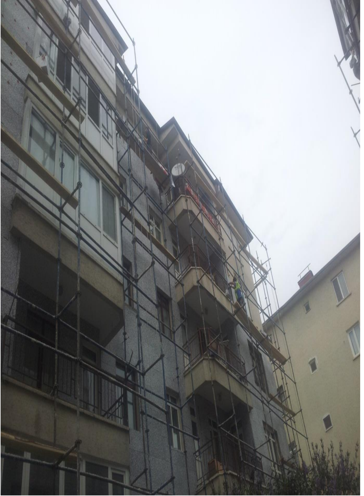
Şekil 32. Sabitlenmemiş Platformlar, KKD'siz Çalışan, Korkuluksuz İskele
