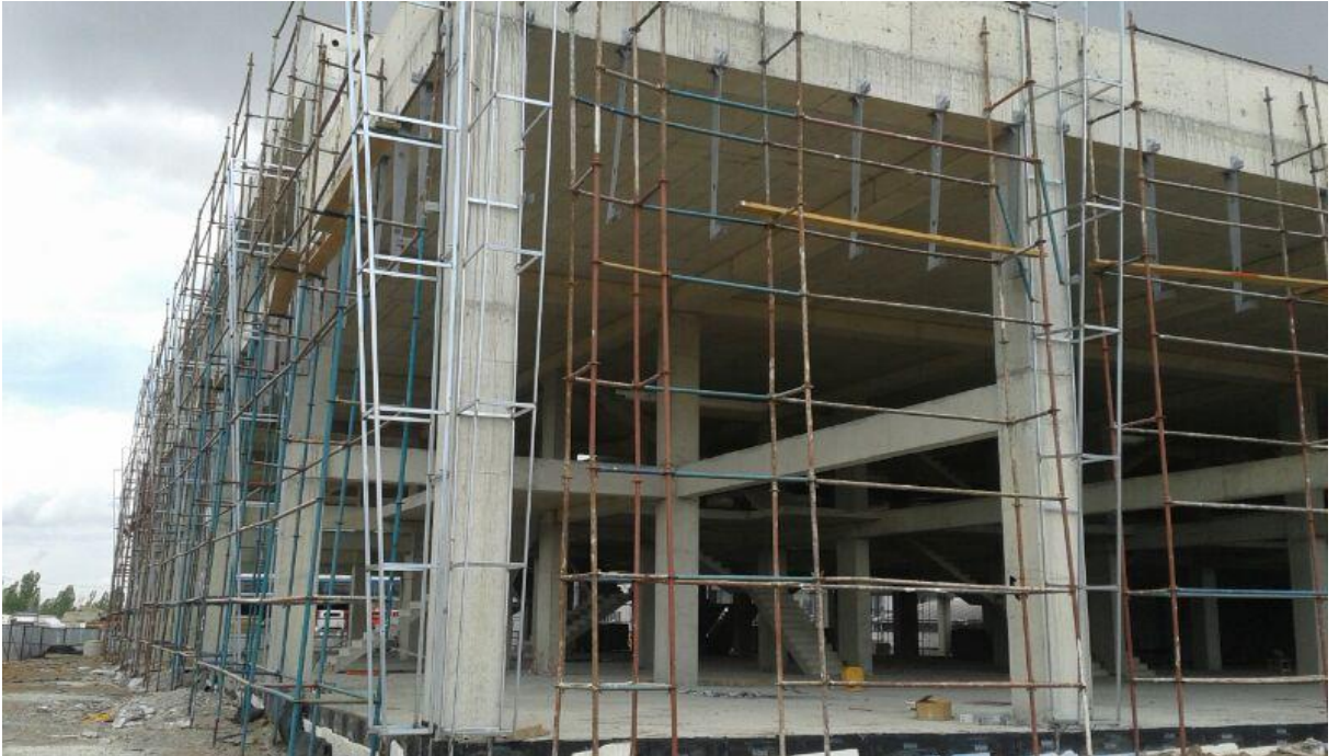
Şekil 66. Platformsuz, sağlam olmayan tabanı güvensiz iskele
