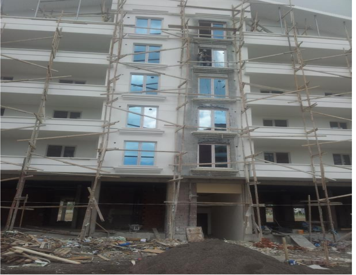
Şekil 56. Korkuluksuz, Platformsuz ve Merdivensiz İskele
