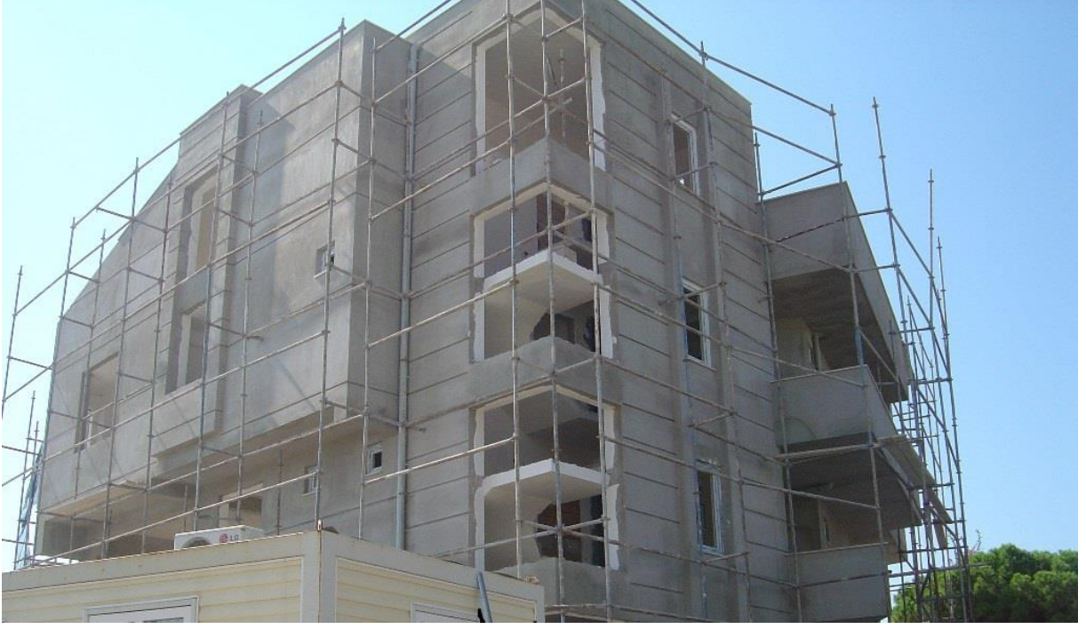
Şekil 69. Standartlara uygun olmayan iskele [22]
