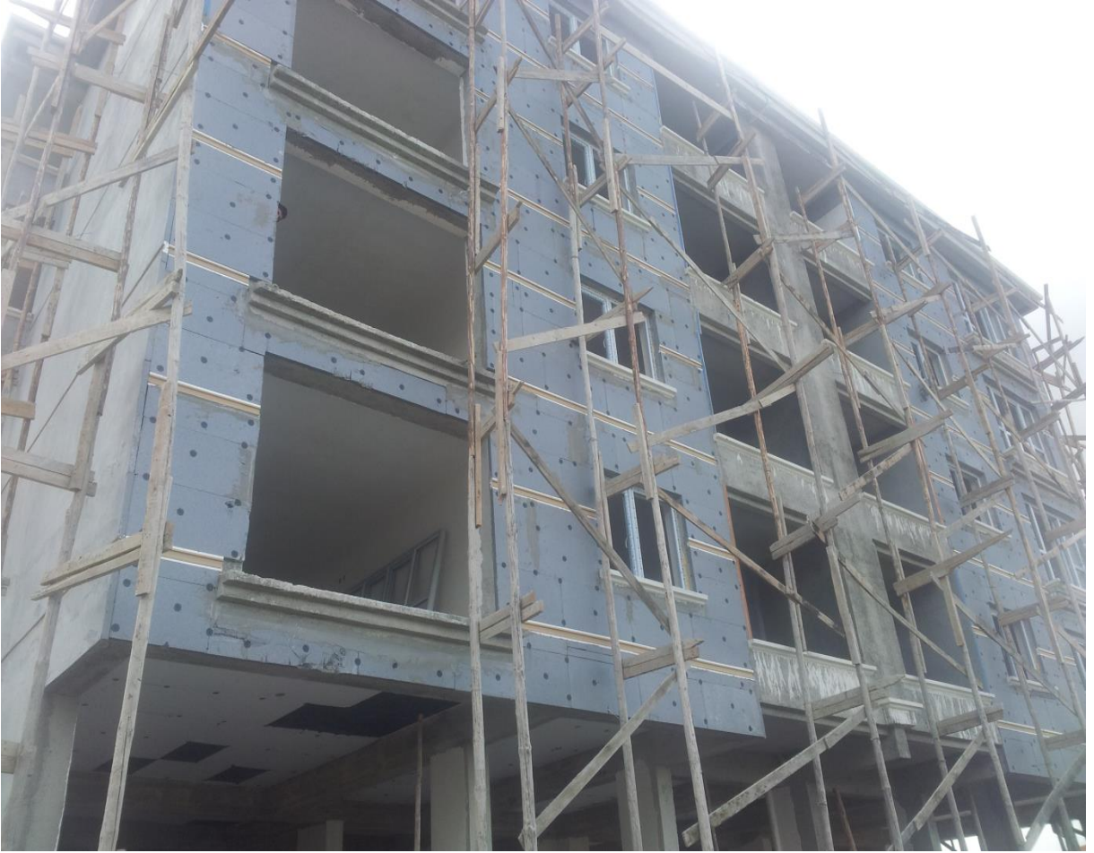
Şekil 54. Korkuluksuz ve Platformsuz İskele
