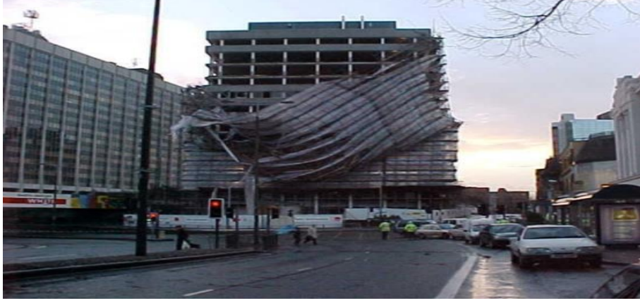
Şekil 15. İskele Bağlantısının Kopması
