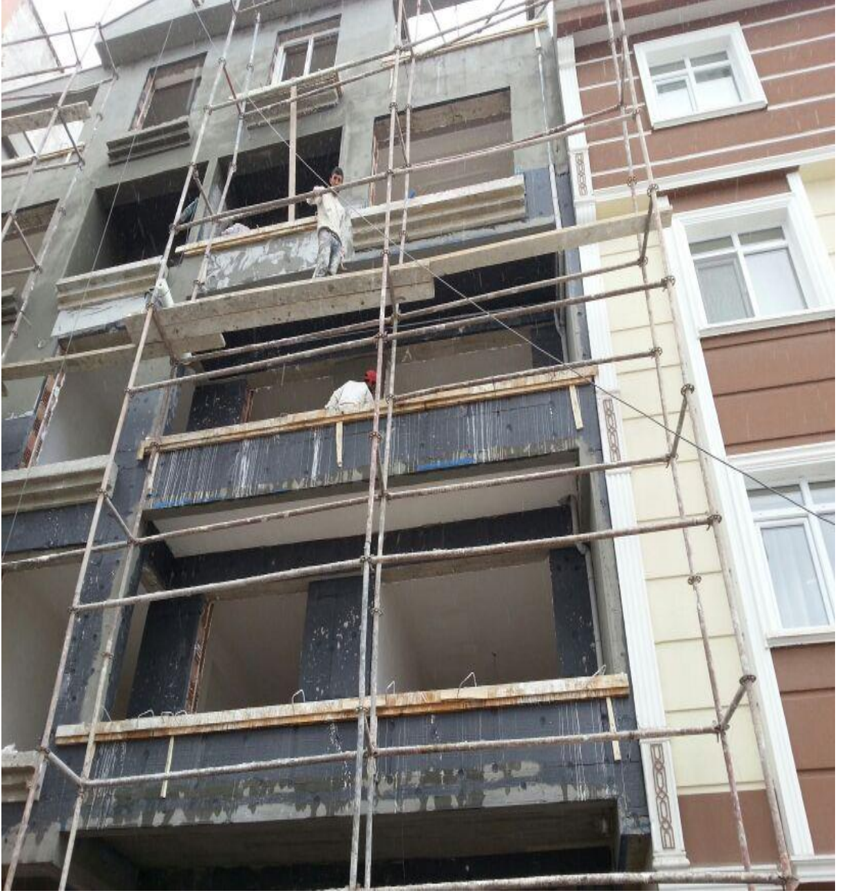
Şekil 52. KKD'siz Çalışan ve Platformsuz İskele
