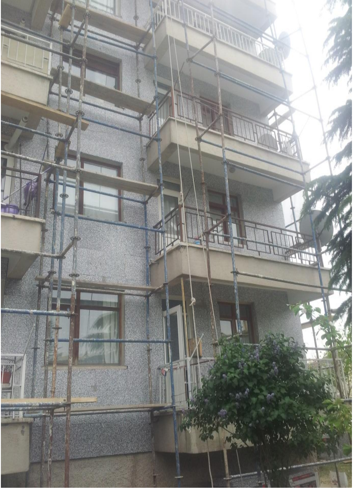
Şekil 33. Sabitlenmemiş Platformlar, Korkuluksuz İskele
