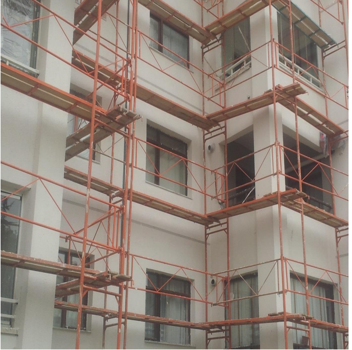
Şekil 49. İskele Korkulukları ve Platformları, Çapraz Elemanlar Yok
