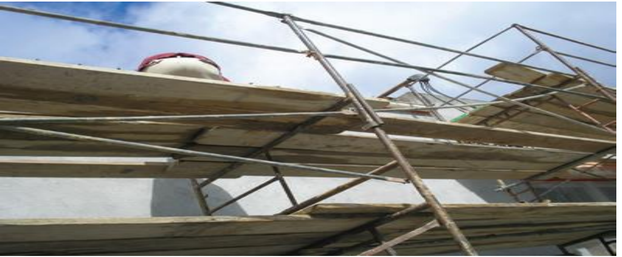
Şekil 79. Standartlara uygun olmayan platform örneği [25]
