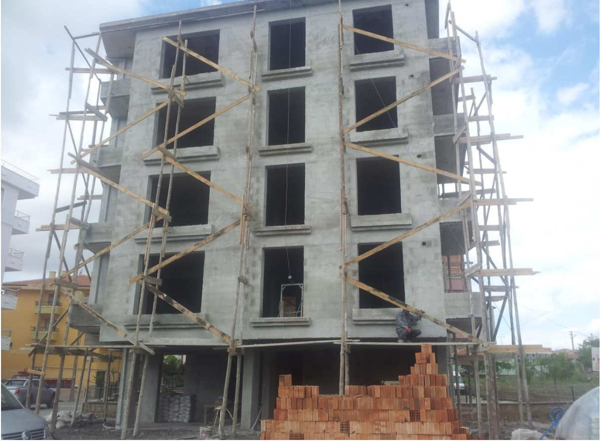
Şekil 55. Korkuluksuz, Platformsuz ve Merdivensiz İskele
