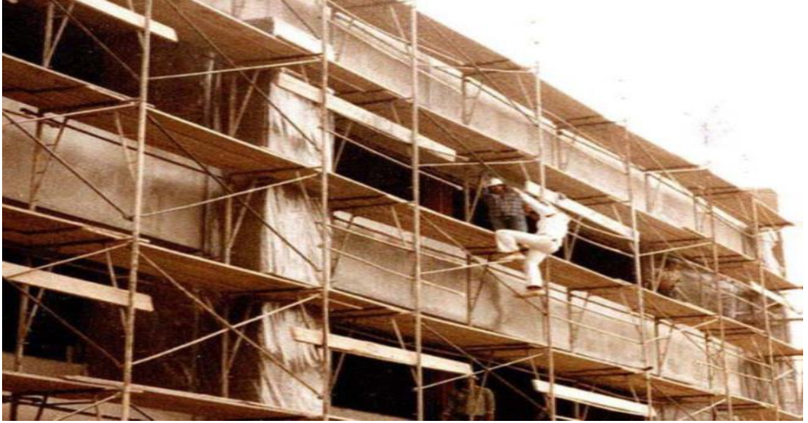
Şekil 81. Çapraz elemanların giriş için yanlış kullanılması [24]
