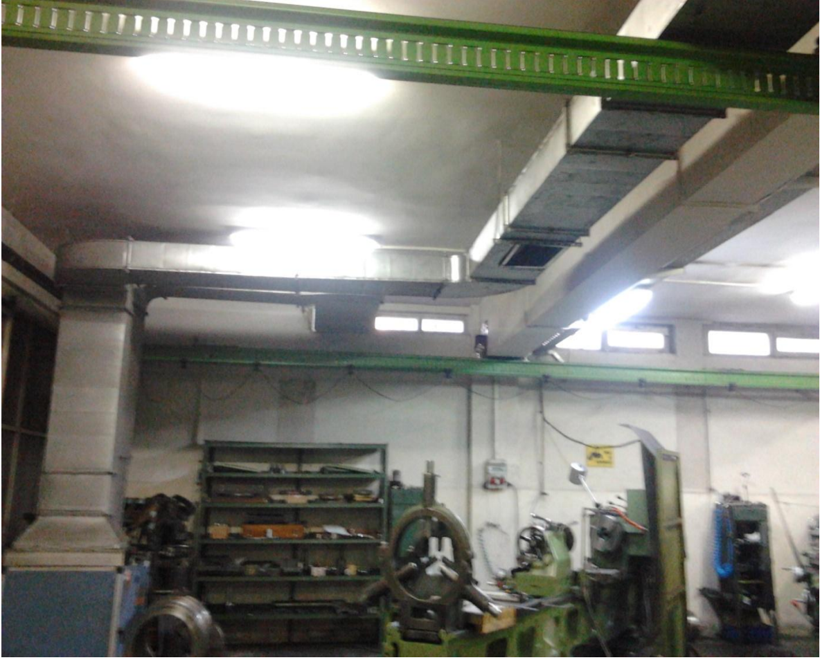
Şekil 7. A kodlu işyerindeki mevcut havalandırma sistemi.
