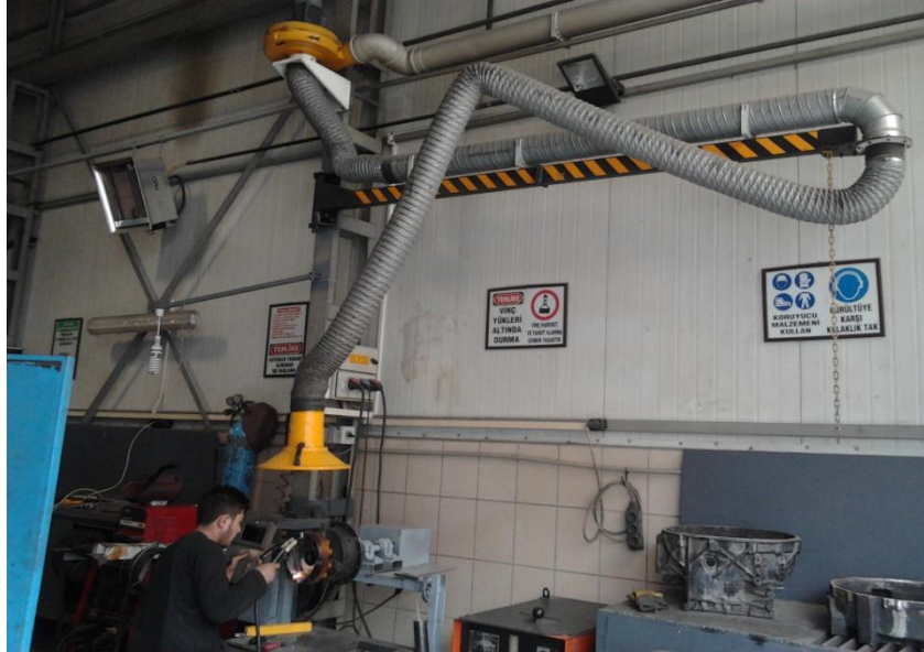
Şekil 16. G kodlu işyerinde bulunan yerel havalandırma sistemi
