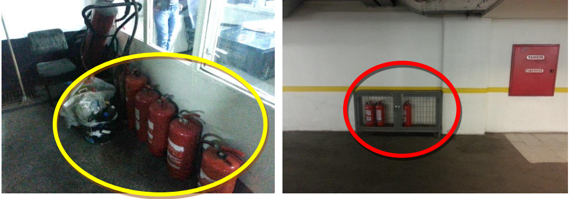
Resim 4.8. Uygun yerleştirilmeyen yangın söndürücü tüplere örnekler
