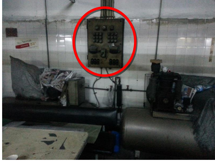
Resim 4.4. Otopark içinde uygunsuz elektrik panosu örneđi
