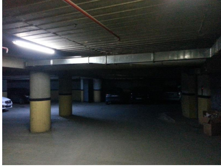
Resim 4.2. Aydınlatmanın yetersiz olduğu otopark örneği
