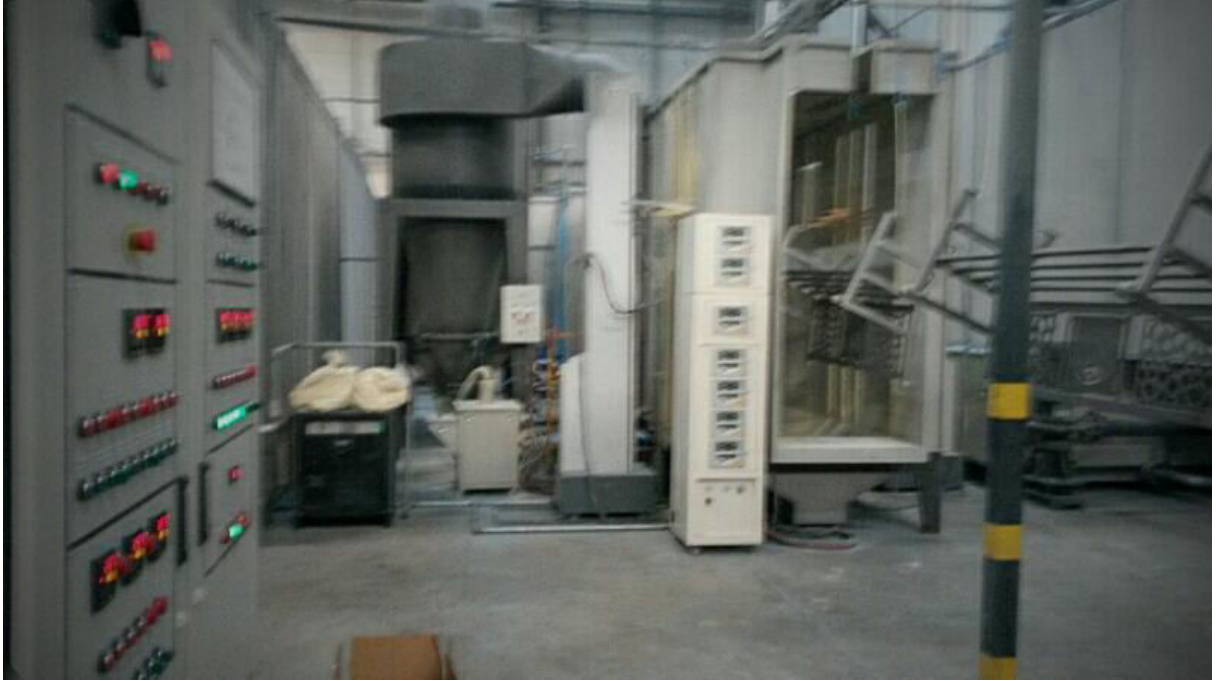
Resim 3.14. Firma C elektrostatik toz boyama ünitesi
