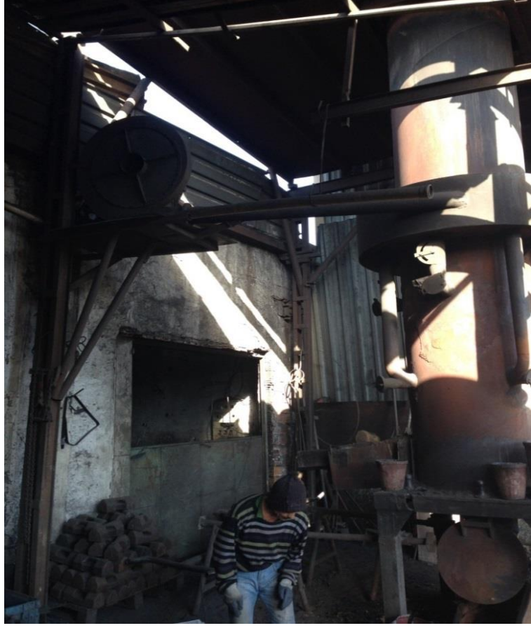
Şekil 26. Kupol Ocak ve Fan Örneği
