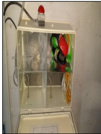
Resim 4.51. KKD'lerin uygun yerde muhafaza edilmemesi
