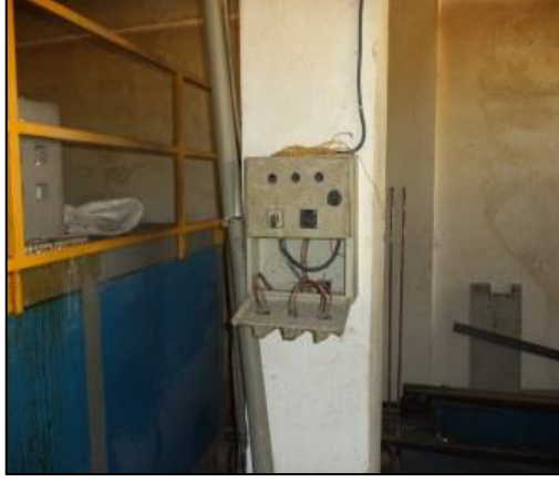
Resim 4.42. Kapağı açık elektrik panosu
