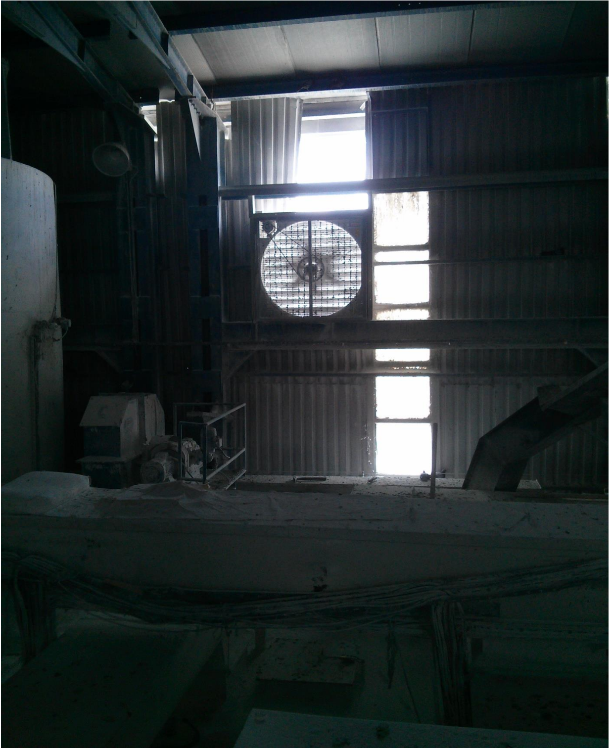
Şekil 28. Mikser bölümünde mekanik havalandırma
