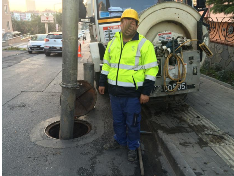
Resim 4.3. Muayene bacası temizleme çalışmasında yetersiz KKD kullanımı
