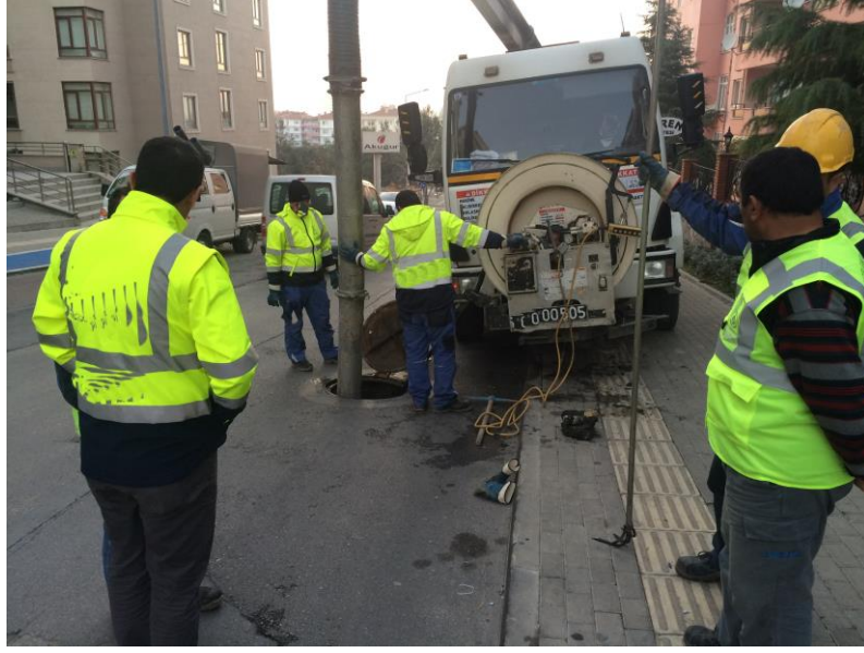
Resim 4.9. Çalışanların su geçirmez tulum kullanmaması
