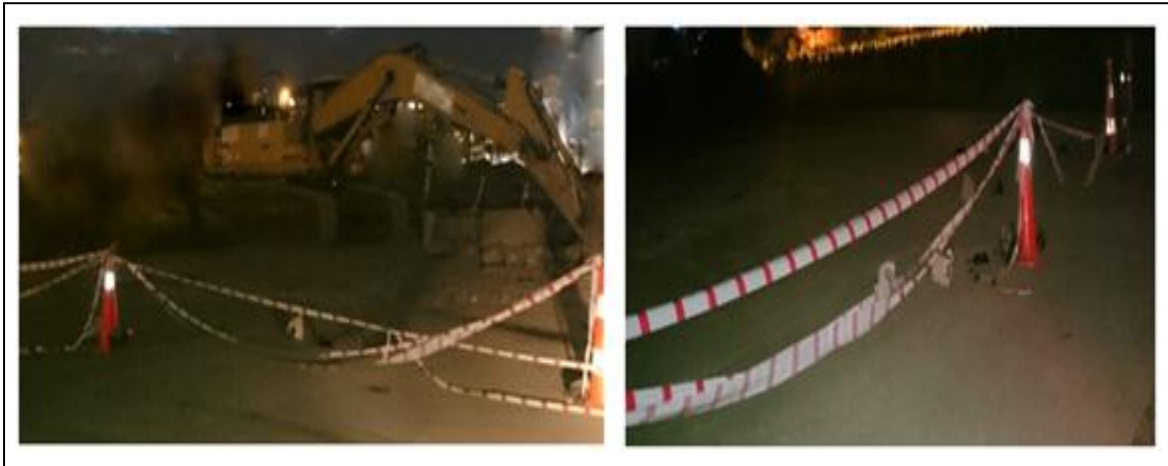
Resim 4.9. Yetersiz Aydınlatma Ve Uyarı Ekipmanlı Gece Çalışması Ortamı
