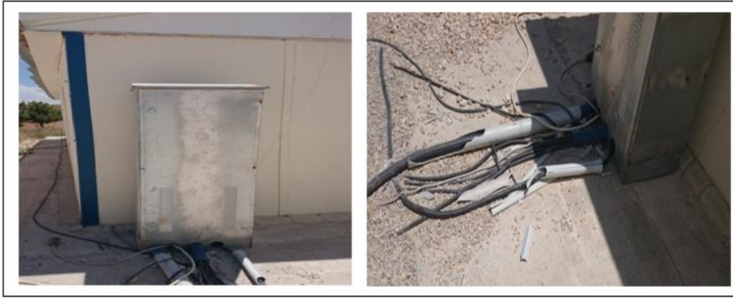
Resim 4.8. Elektrik Kaynaklı Tehlike Oluşturan Kablo Ve Panolar
