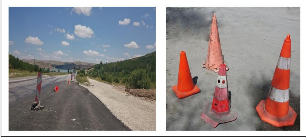
Resim 4.17. Uygun Olmayan Uyarıcı Ve Sınırlayıcı Ekipmanlar
