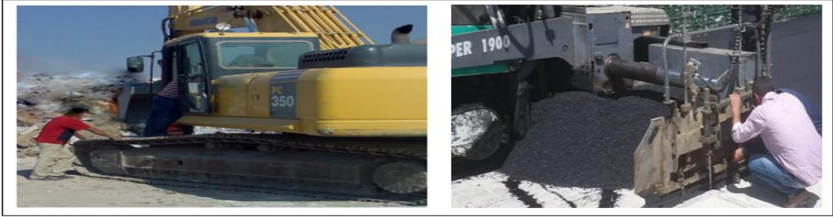
Resim 4.4. Bakım, Onarım, Temizlik Çalışmalarında KKD Kullanılmaması
