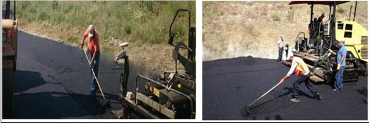
Resim 4.16. Koruyucu Ekipmanlar Olmadan Sıcak Alanlarda Çalışılması
