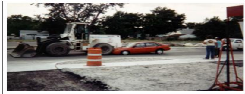
Resim 2.1. Yeterli Ara Açıklık Bulunmadığında Oluşan Kaza Örneği [12]
