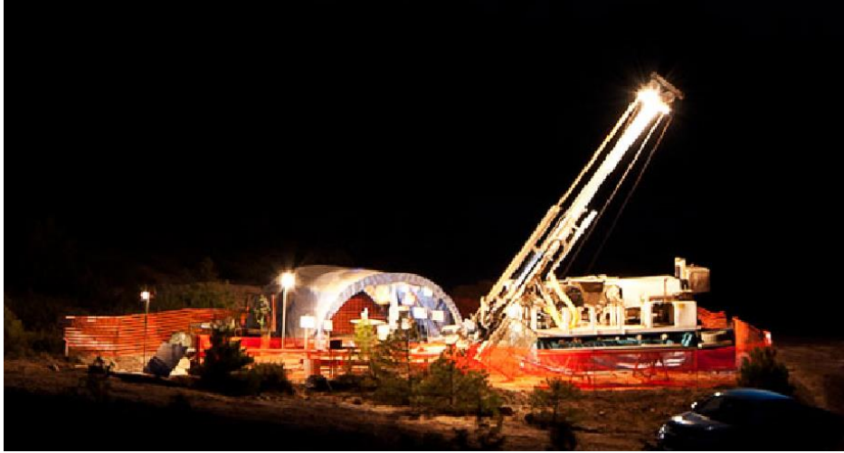
Resim 4.28. Gözlem yapılan sahaların birinde yer alan gece aydınlatma sistemi
