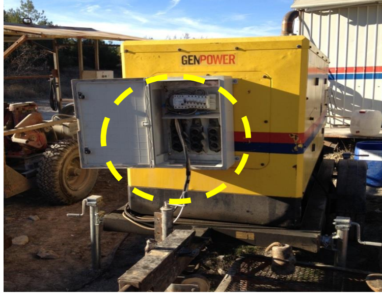
Resim 4.2. Uygunsuz elektrik panosu
