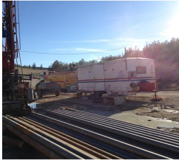
Resim 4.23. Gözlem yapılan sahaların birinde yer alan ve çalışma sahası üzerinden geçirilen elektrik kablosu
