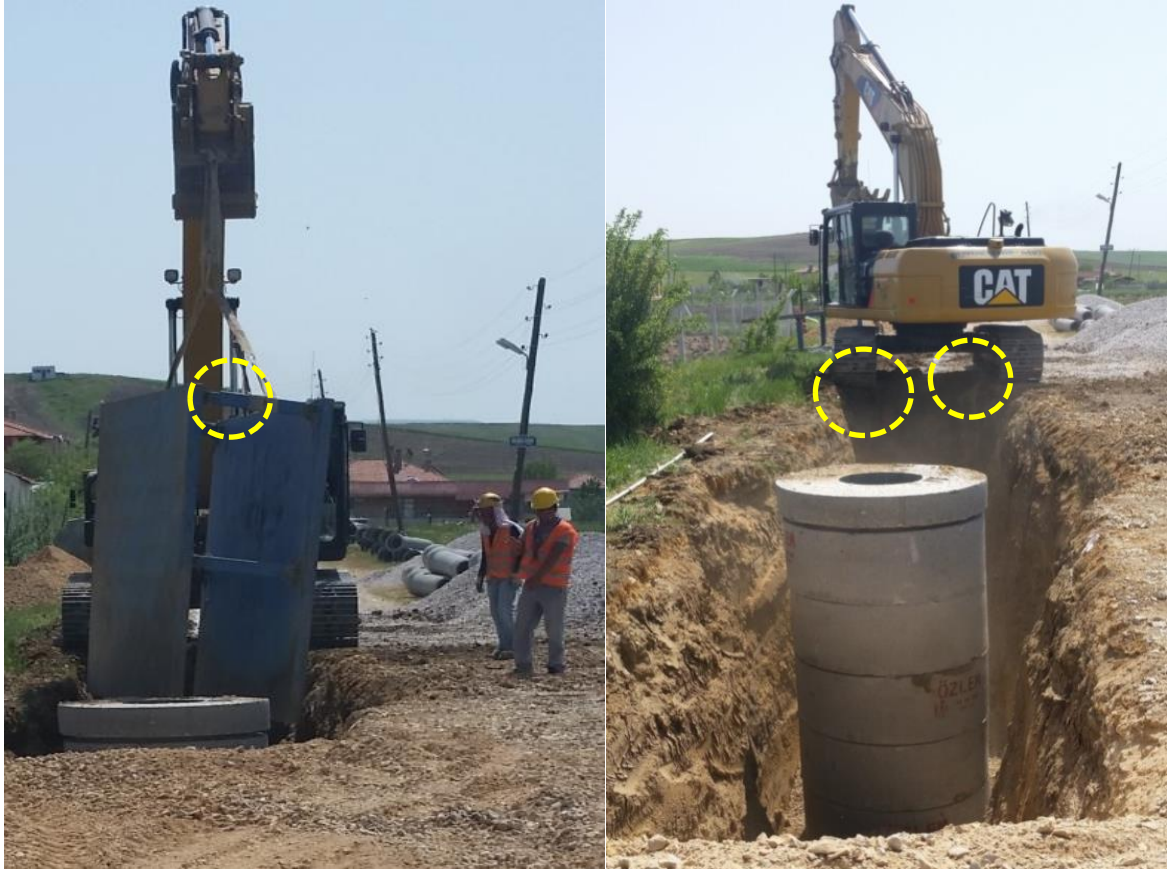
Şekil 4.7. Kayaç Olmayan Zemin ve Uygun Olmayan Hendek Kaplama Sistemi
