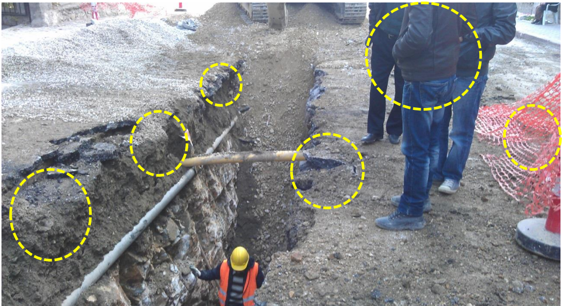
Şekil 4.4. Kazı İçerisinde Tedbirsiz Çalışma
