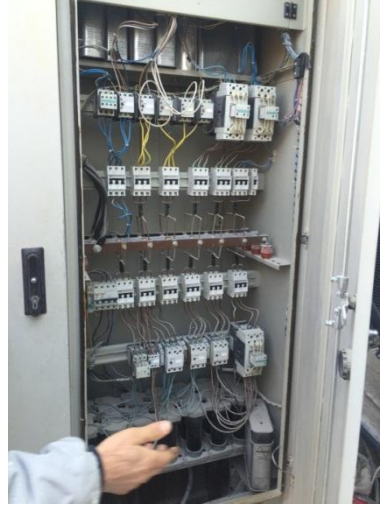
Resim 4.18. Elektrik panosu örneđi
