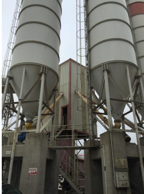
Resim 2.4. Çimento, katkı malzemesi siloları ve helezonlar
