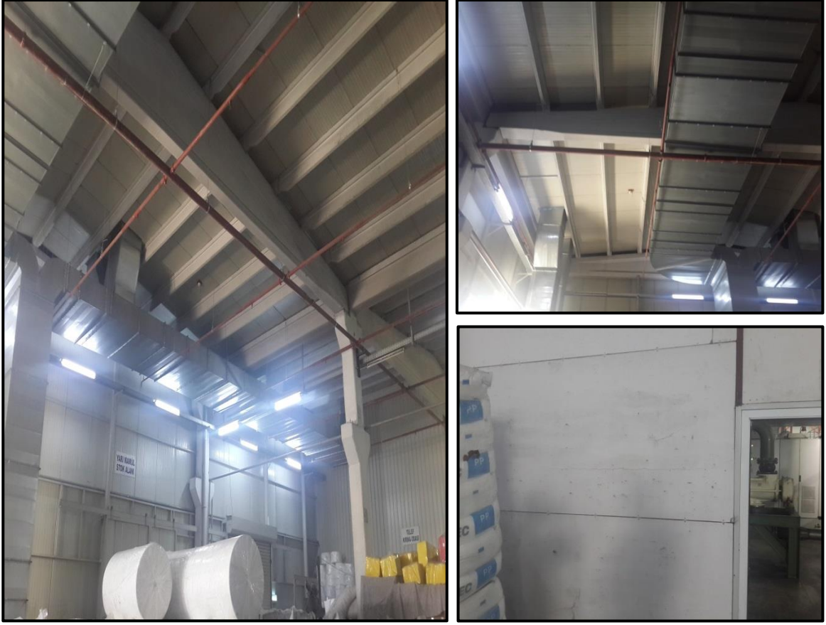
Resim 4.31. Depo alanlarında alev dedektörleri, sprinkler tipi yangın söndürme sistemleri ve yanmaz malzemenen duvar kaplama uygulamaları
