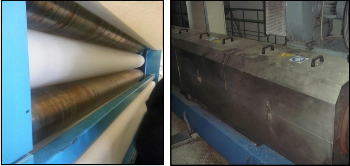
Resim 4.9. Yüksek yüzey sıcaklığı tehlikesi arz eden ana proses unsurları
