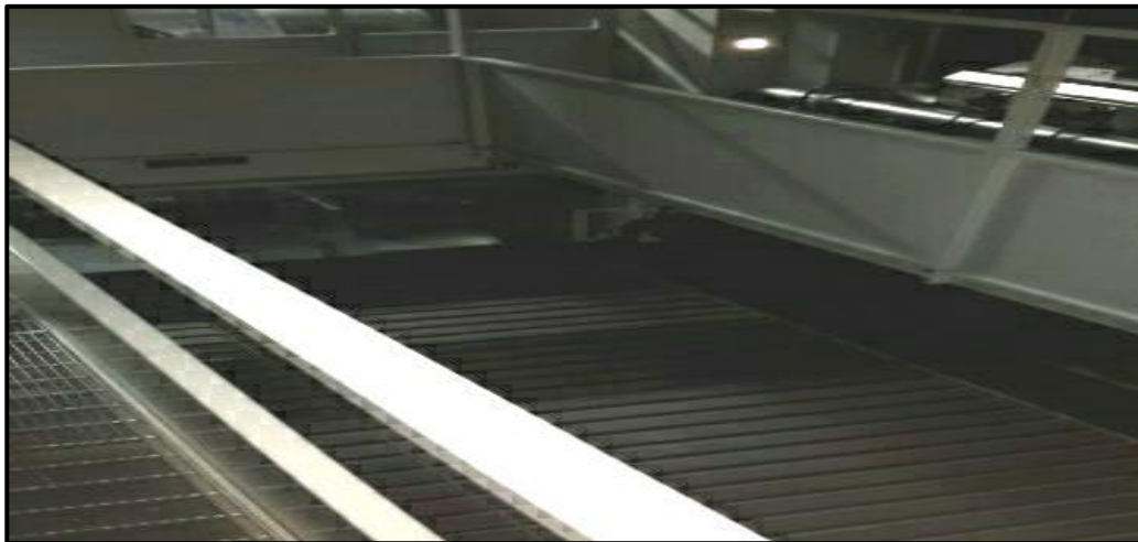
Resim 4.10. Kafesli muhafazası bulunmayan konveyör
