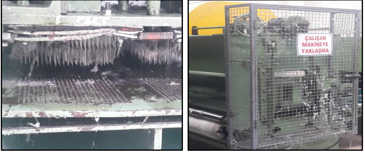
Resim 4.44. İğneleme işleminde iğneli plaka çalışma bölgesine uzuv kaptırma riskini önlemeye yönelik muhafaza uygulaması
