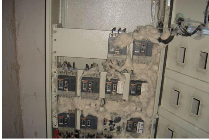
Resim 2.1. İçi hav dolmuş elektrik panosu [25]
