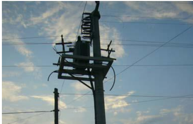
Şekil 7: Direk tipi transformator
