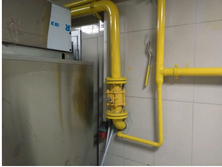
Resim 4.11. Akış yönü belirtilmemiş doğalgaz borusu
