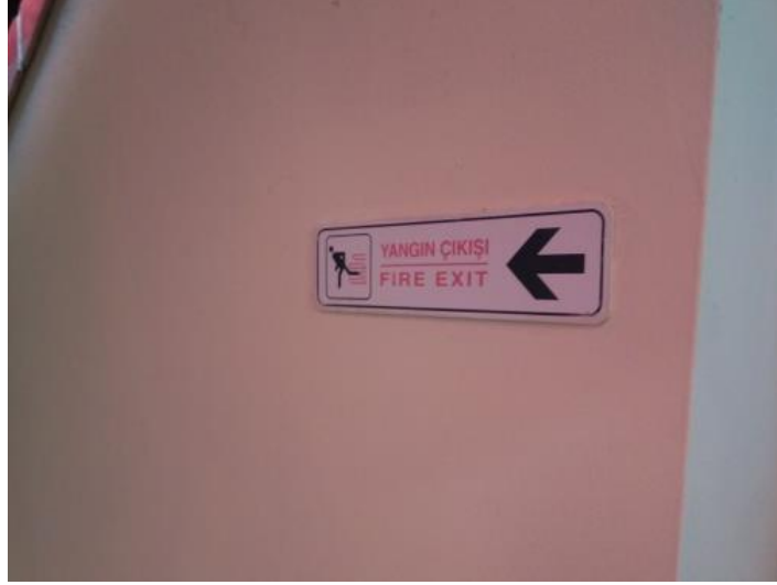
Resim 4.4. Uygun olmayan acil çıkış levhası
