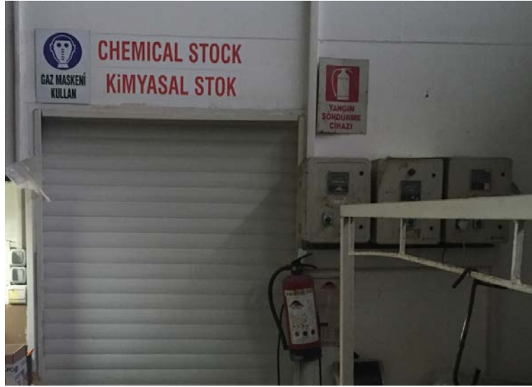
Resim 4.15. Elektrik panoları ve kontrol üniteleri
