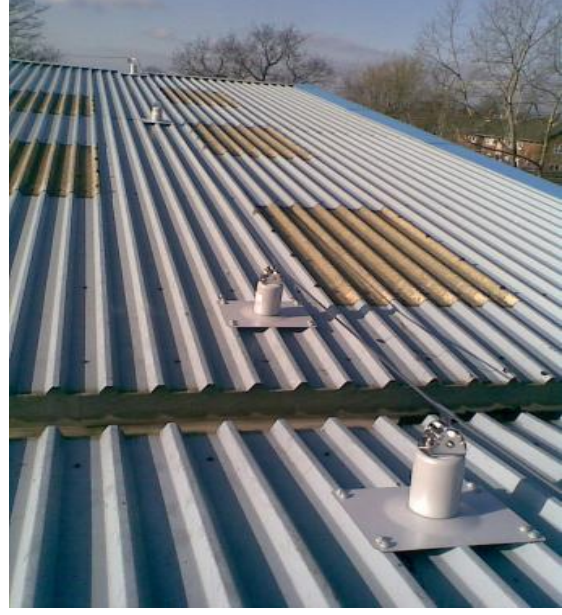
Çatılarda Yaşam Hatları
