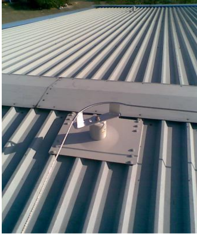
Çatılarda Yaşam Hatları
